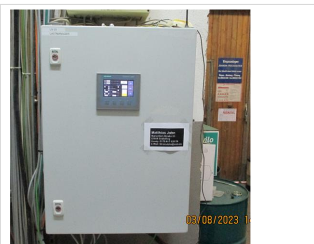
Kopfsteuerung für 3 Gasverbraucher (hier 2 BHKW + 1 Biogasheizkessel)
